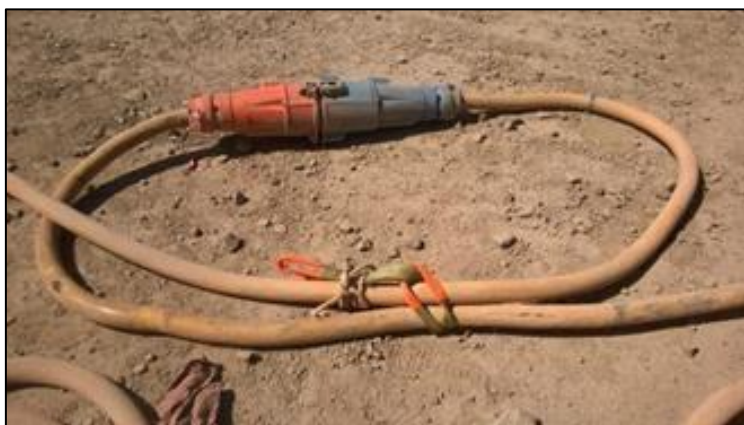
Figura 3. Cables Eléctricos mina.
