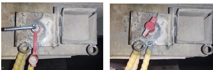
Apertura de interruptor de Corta Corriente
