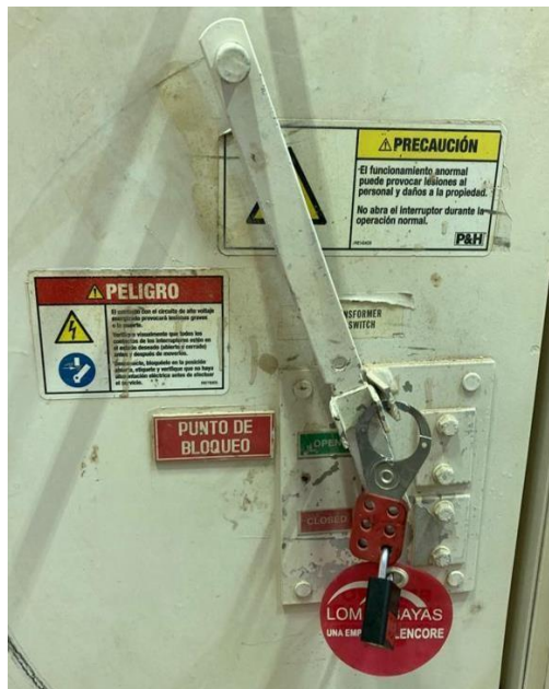
Bloqueo en desconectador del transformador principal
