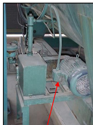
COMPRESOR SUMINISTRO AIRE PRIMARIO AL CALENTADOR
