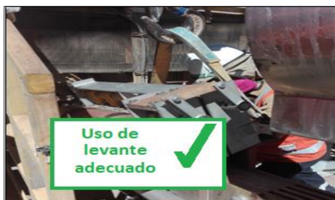
Imagen 2.1 muestra la forma correcta del traslado de Switch.
