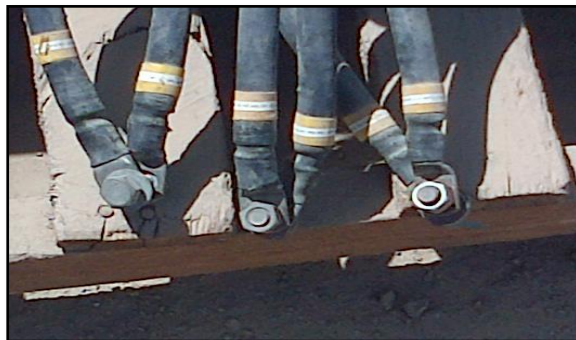
Fig.5.1 Bobinas de los motores no identificados.
