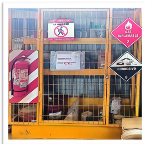
Figura 3. Jaula Contenedora de Sustancias Peligrosas.
