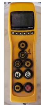
Control Puente grúa 1 Tn.
