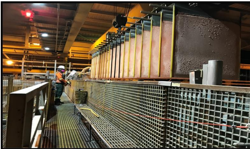
Foto 5: Operador posicionado en nivel superior de MDC, fuera el alcance de la araña (línea de fuego) por desplazamiento imprevisto del puente.
