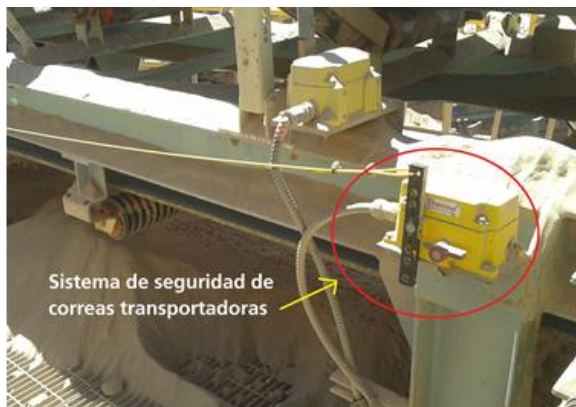
Imagen N°1: Sistema de emergencia para correas transportadoras.
