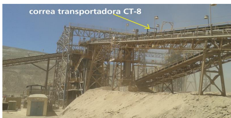
Imagen N°9: Indicación del lugar de correa transportadora CT-8
