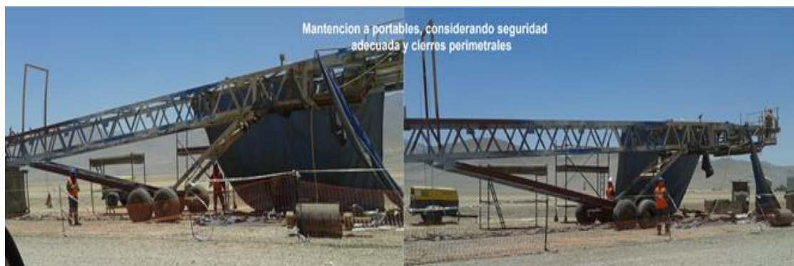
Imagen N°5: Mantención de correas con cierre perimetral correspondiente al estándar de seguridad.
