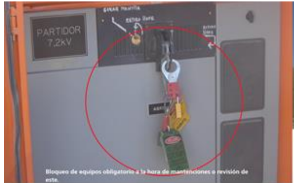
Imagen N°6: Bloqueo de equipos
