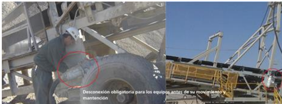
Imagen N°7: Desconexión de cables de alta tensión entre alimentador
