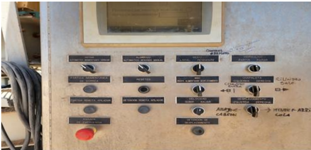
Imagen N°10 tablero posición de selectores una vez detenido el traslado.
