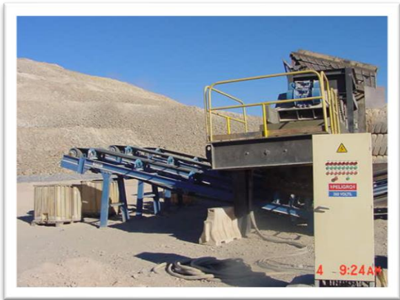
Fotografía N° 1. Vista Frontal Planta Piloto Harneros.
