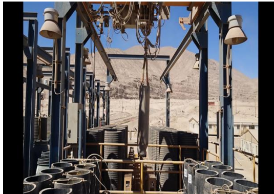
Figura N°3: Traslado de carga sin obstáculos.
